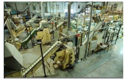
50. Instalações recentes (Vila do Conde)
